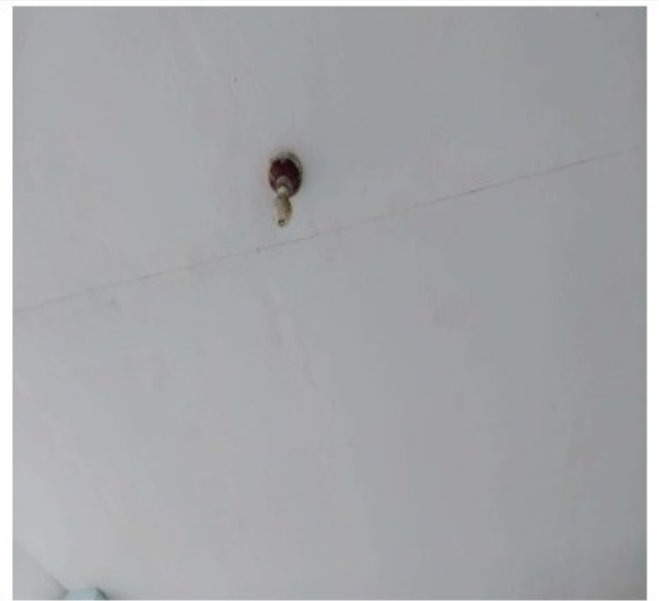
Foto lampu penerang di lapak sudah ada, dalam kondisi baik dan cukup untuk menerangi sekitar
