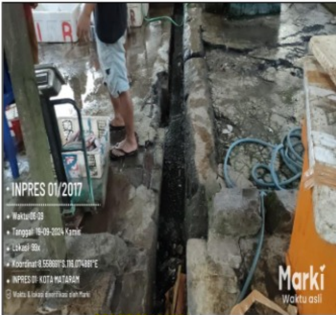
Foto saluran air disekitar lapak, kondisi tidak terawat dan kotor
