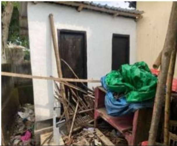
Kondisi toilet di pasar Pelangan, dan air tidak memenuhi standar
