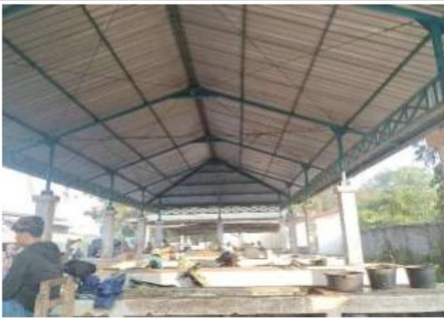
Foto atap bangunan di Pasar Gerung
