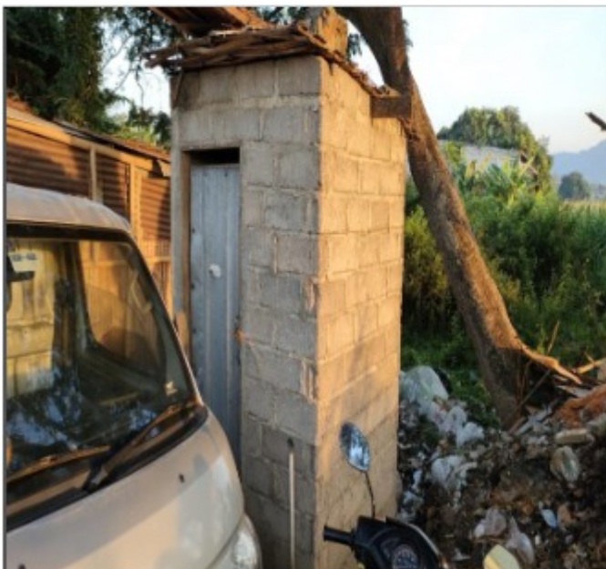
Foto kondisi toilet di pasar Ampenan, pintunya rusak tidak ada bahan sanitasi
