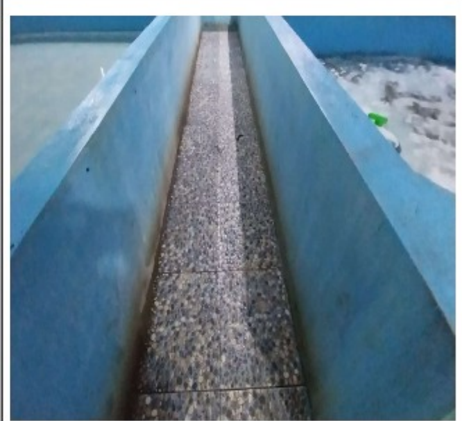
Foto kondisi lantai Lobster Estate
